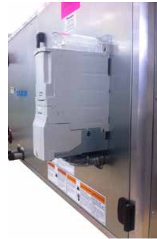
VFD & Conduit Box
